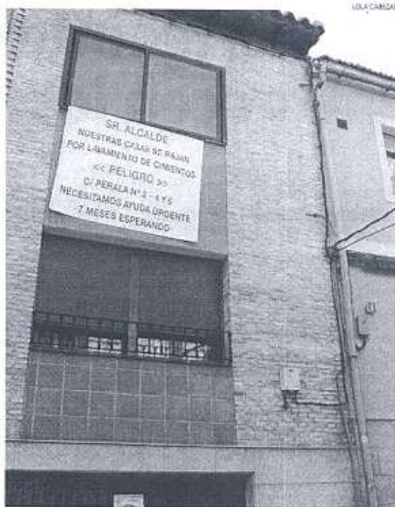
Pancarta situada en una de las viviendas afectadas por las grietas.
